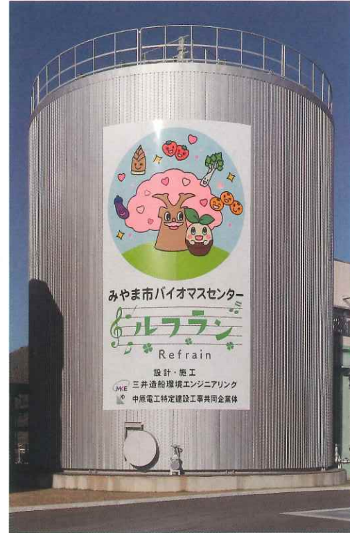
メタン発酵槽
