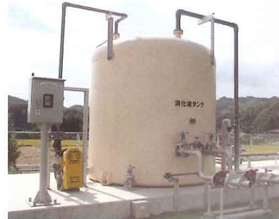
消化液タンク
