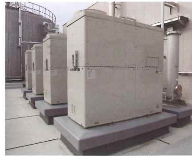
バイオガス発電機
