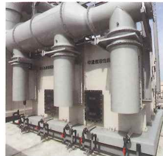
活性炭脱臭塔
