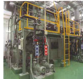
生物脱臭塔・薬液脱臭塔
